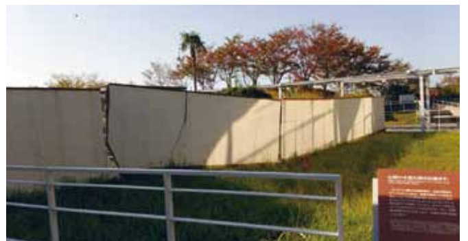
断層が横切る民家の塀
